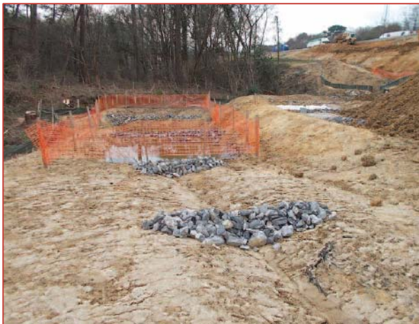
↑ Noue équipée de seuils en granulats concassés
